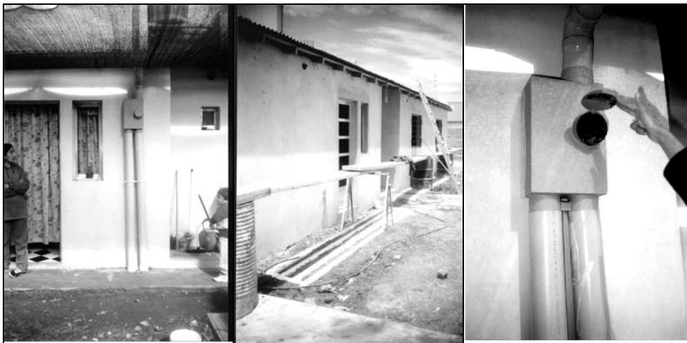
Figura 12: Regulador domiciliario instalados en un plan de viviendas.
