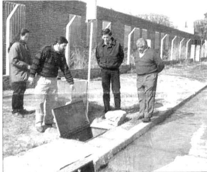
Figura 4: Instalación experimental del dispositivo regulador en bocas de tormenta.
