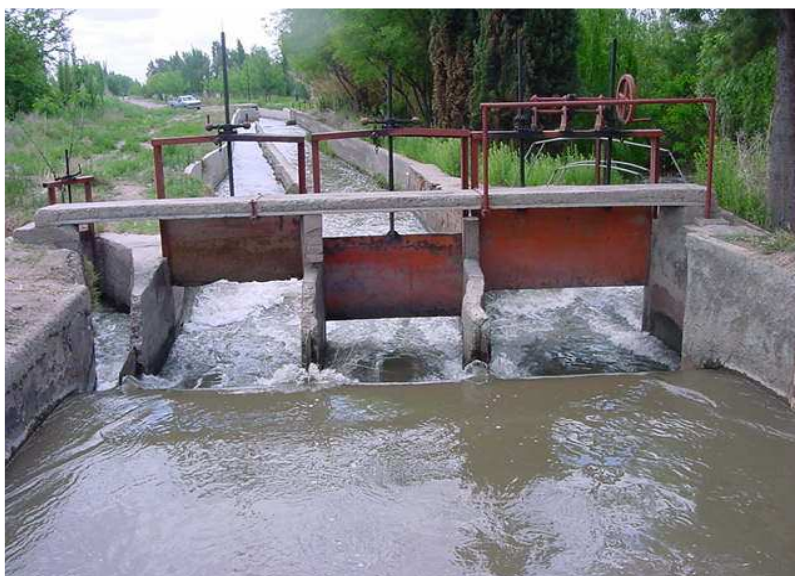
Foto 2: Cuádruple compartó (Canal Jocolí, Tres de Mayo, Lavalle) Estructuras de toma de sus 4 hijuelas de riego
